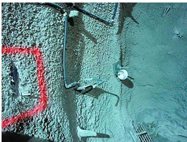
Figure 21 Cellule de pression installée pour être enrobée dans le béton projeté de la galerie GRD2
