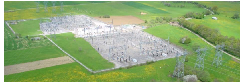
Exemple de poste 400 000 / 225 000 volts à Mambelin dans le Doubs
