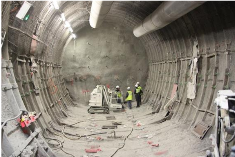
Figure 3.3-8 : Creusement de la chambre de montage du tunnelier pour l'essai GVA2 au Laboratoire souterrain (diamètre excavé de 9,1 m)
