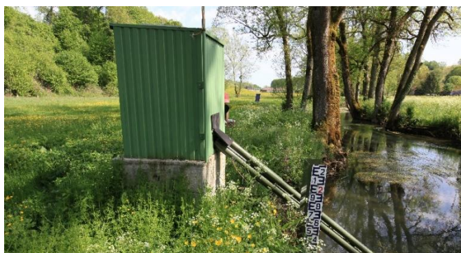
Station instrumentée sur un cours d'eau
